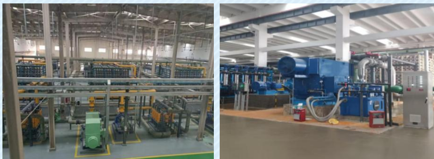
山东鲁北高新技术开发区海水淡化供水保障工程
